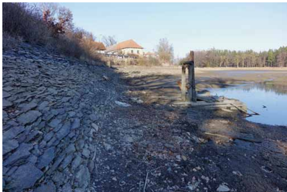
Obr. 4.53: Zbýšou (okres Kutná Hora), Zbýšovský rybník – kamenný taras návodní strany hráze. Foto Jindřich Frajer, 2022.
