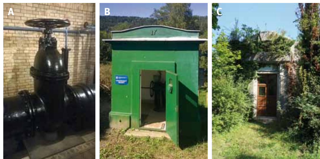
Obr. 3.3: 1. březovský vodovod: (A) manipulační uzávěr vody; (B) šoupátková komora; (C) vstup do zemního vodojemu Holé hory 2; litinový dálkový přivaděč pitné vody o délce 57 km, který se zachoval v původním provedení, vyjma modernizace dálkového ovládacího strojího vybavení. Foto David Honek, 2019.
