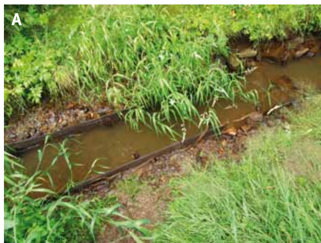
Obr. 5.12: Blatenský vodní příkop – poškozené úseky vodního příkopu: (A) narušení erozí a vymíláním; (B) – (D) ohrožení a poškození dřevinami v blízkosti koryta náhonu. Foto Miloš Rozkošný, 2020.
