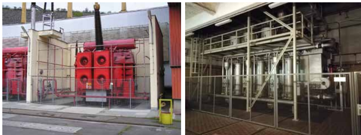
Obr. 4.180: Blokové transformátory: (A) PVE Dalešice; (B) PVE Dlouhá stráně. Foto VUT v Brně, FAST, 2019.
