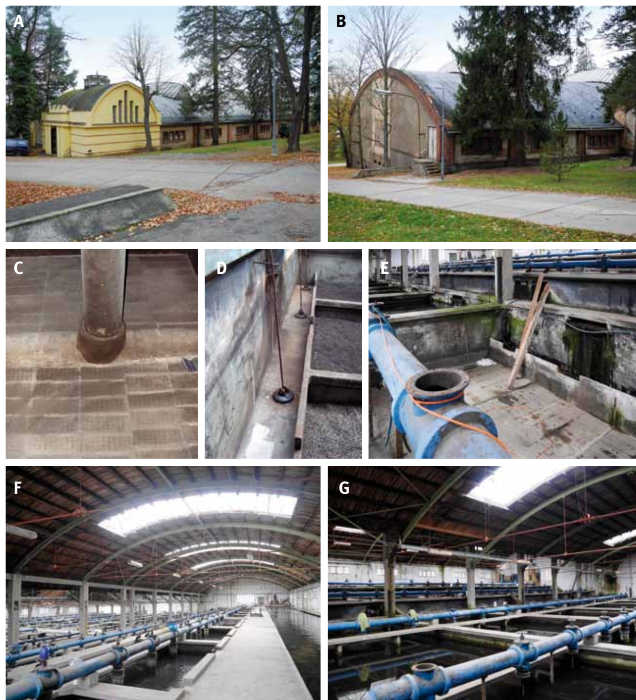
Obr. 5.20: Plzeň – budova Puech-Chabalovy filtrace: (A) hlavní vstup a nejužší položená severovýchodní hala; (B) nejnižší položená jihozápadní hala; (C) – (E) čištění jednotlivých nádrží; (F) a (G) haly za současného provozu. Foto (C) a (D) Jan Mikač, 2015; (A), (B), (E) – (G) Michaela Ryšková, 2020.
