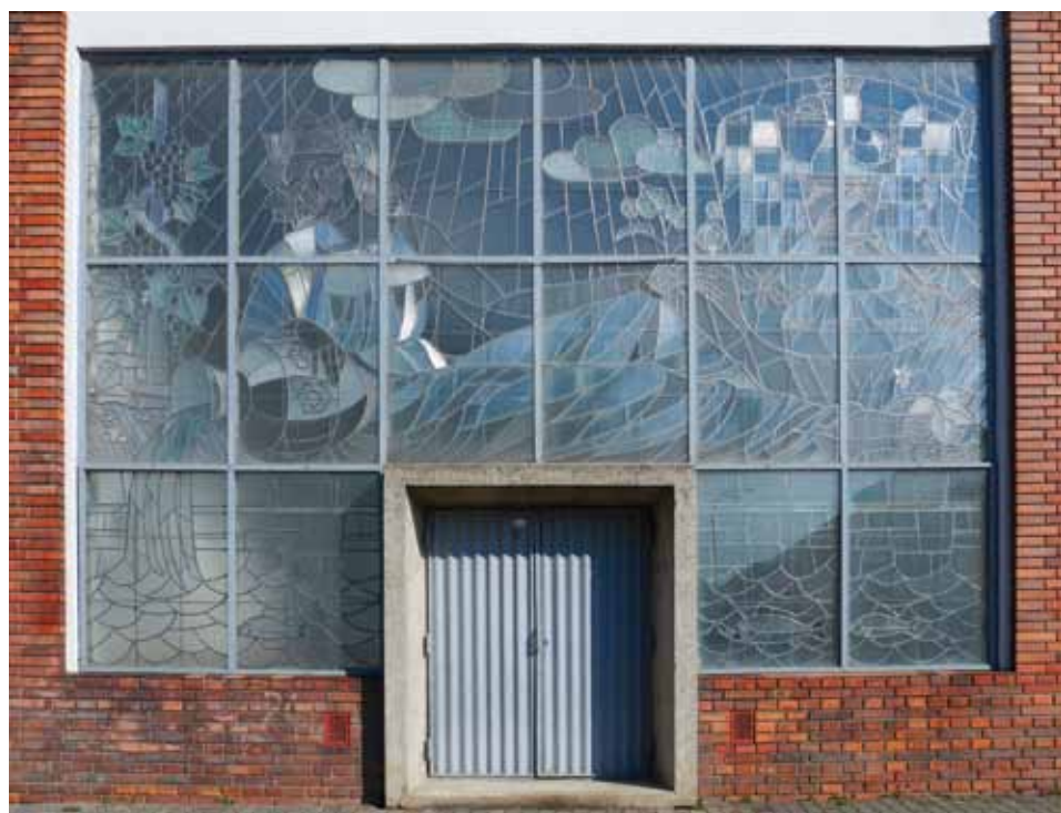
Obr. 3.19: Znojmo – zemní vodojem se dvěma železobetonovými kruhovými nádržemi byl postaven v letech 1949–1950 podle návrhu Vítězslava Lorenze. Pro okno v uličním průčelí byla zhotovena vitráž Alegorie řeky Dyje z různě strukturovaného skla provedená podle návrhu Vojtěcha Kubašty roku 1950 (Stará, 2007). Foto Michaela Ryškové, 2020.
