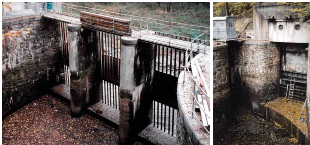
Obr. 4.143: Derivační MVE Spálov – otkový objekt, stav bez vody v době opravy v roce 1998. Foto VUT v Brně, FAST, 1998.
