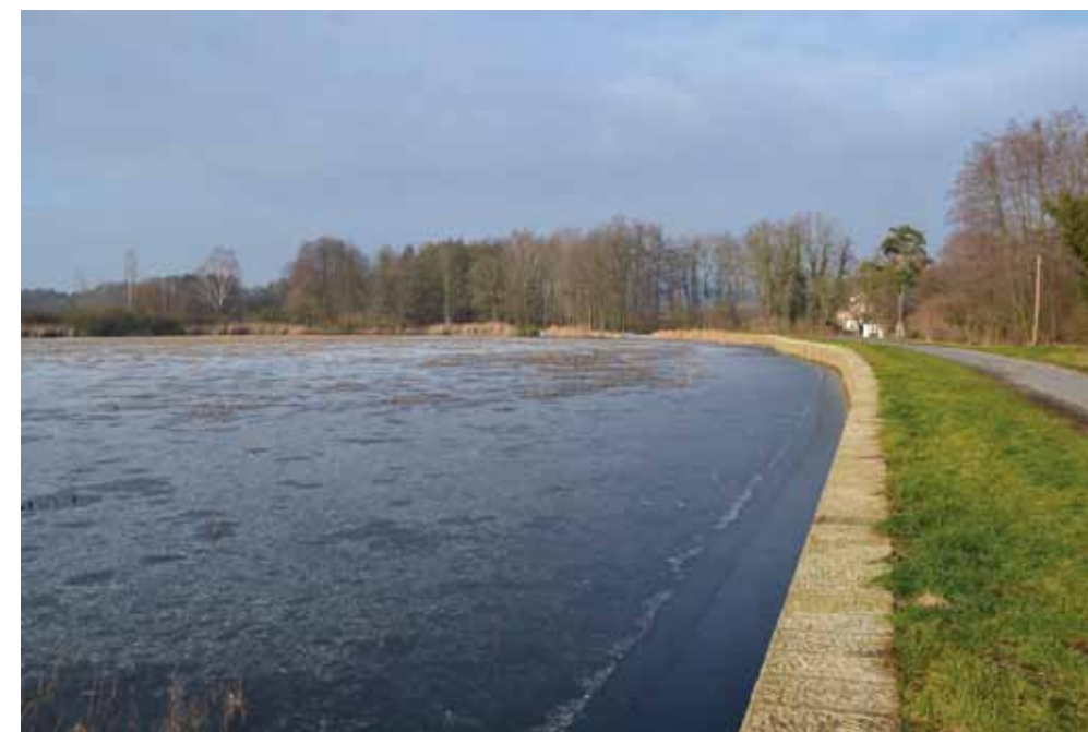
Obr. 4.51: Holany, Holanský rybník – vydutý tvar hráze s obnovenou návodní zdí z pískovcových kvádrů. Foto Miroslav Kolka, 2018.
