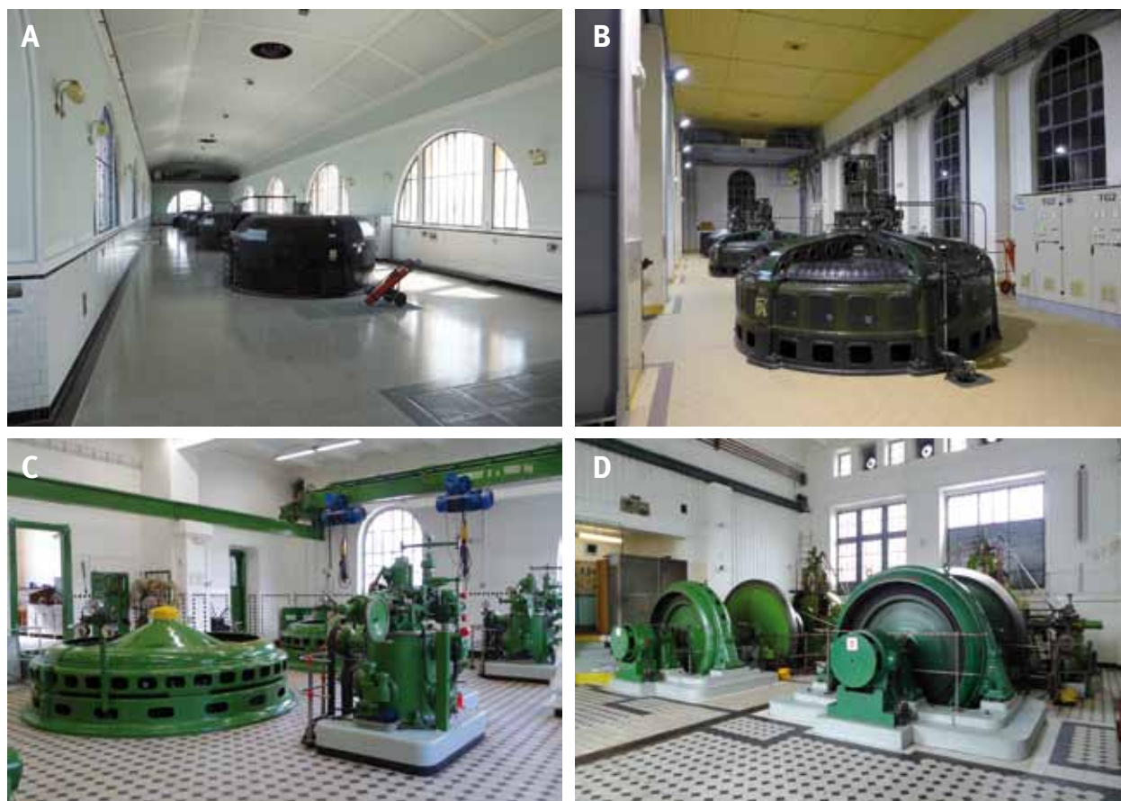
Obr. 4.159: Strojovny: (A) MVE Miřejovice; (B) MVE Kroměříž; (C) MVE Hradec Králové – Hučák; (D) MVE Hradec Králové. Foto (A) VUT v Brně, FAST, 2014; (B) Miloš Matěj, 2014; (C) a (D) Michaela Ryšková, 2010.
