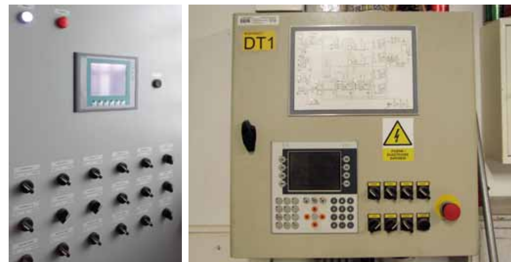
Obr. 5.29: Dnes již historická zařízení pro řízení provozu ČOV. Foto Miloš Rozkošný, 2021.
