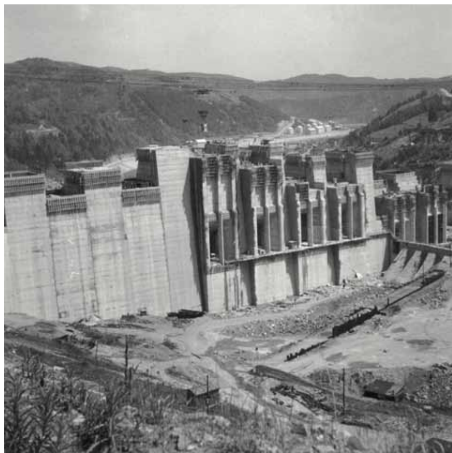
Obr. 4.144: VD Orlický – ve výstaobě, detail bloků s otoky na VE. Foto archiv VUT v Brně, FAST.
